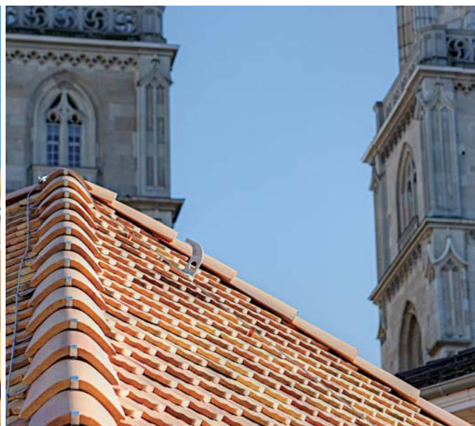
Das Dach zeigt eine vorbildlich schnurgerade verlegte Dachkante mit einer Leitung der Blitzschutzanlage.
